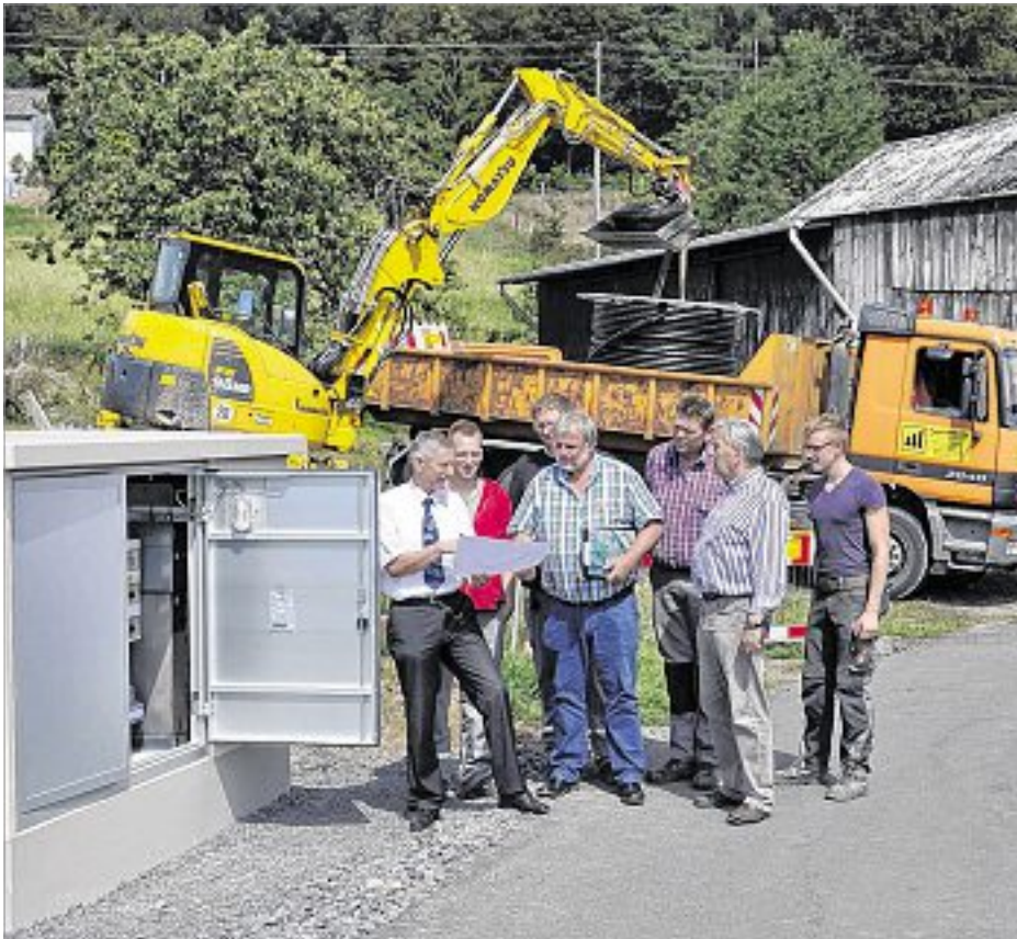
Der Leiter der Netzregion, Reinhard Stark (l.), informierte Friesenhagens Ortsbürgermeister Norbert Klaes (M.) jetzt über den Stand der Arbeiten; mit im Bild Reinhold Kappenstein vom Tiefbauunternehmen Kappenstein (2. v. r.) sowie Mitarbeiter der EnergieNetz Mitte und der Baufirma. Foto: EAM
