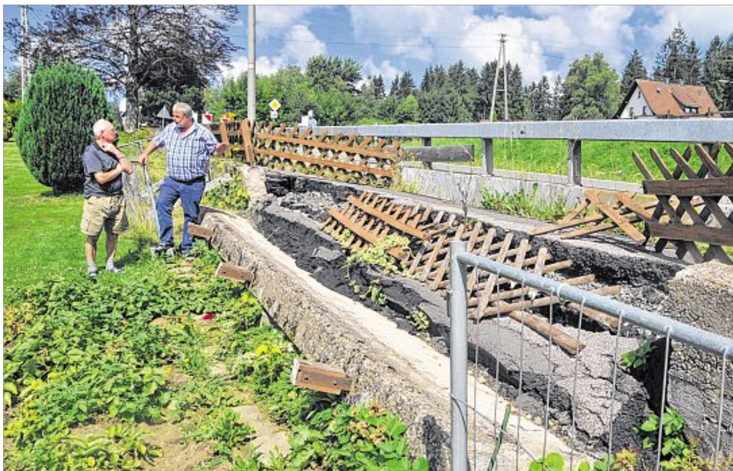
Vor zweieinhalb Jahren ist die Stützmauer an der K 84 im Weiler Wildenburg Bahnhof eingestürzt – seitdem liegt sie im Garten von Paul Selle. Kein Wunder, dass Selle (l.) die Ausführungen von Ortsbürgermeister Norbert Klaes sehr erfreut zur Kenntnis genommen hat: Noch in diesem Jahr soll das Problem gelöst werden. Fotos: damo
