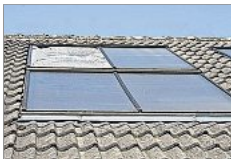
Ein Bild auf vielen Dächern: Solar-Paneelen waren zu Bruch gegangen.
