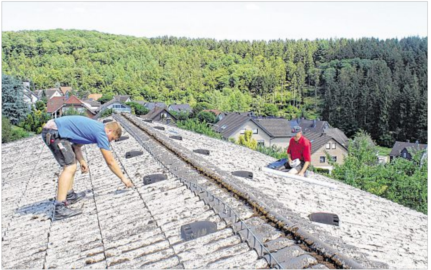
Die Dachdecker Konrad Löcherbach (r.) und Lukas Hüsich schauten sich gestern die Schäden auf dem Dach der Mehrzweckhalle in Friesenhagen an und klebten die Löcher provisorisch ab. Fotos: thor/privat
